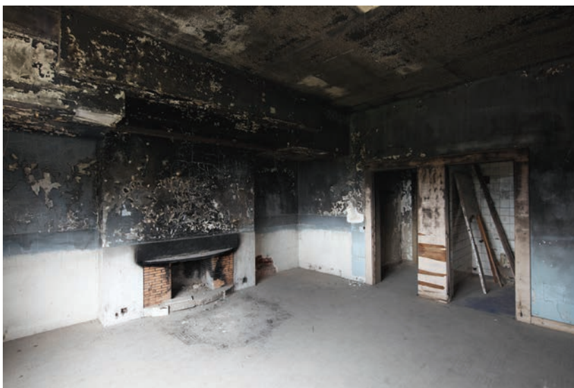
7. Villa Cavrois, boudoir vandalisé (état en 2012). Photo Jean-Luc Paillé / CMN
